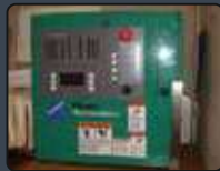
1875 KVA-2000 KVA PCC 3201
